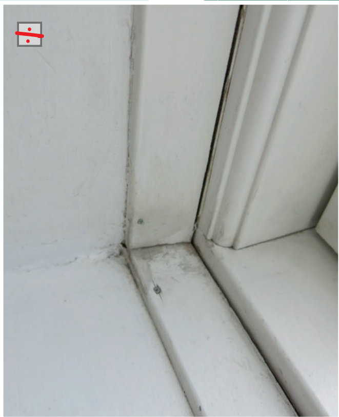
Billede 7: Dårligt udført malerarbejde.
