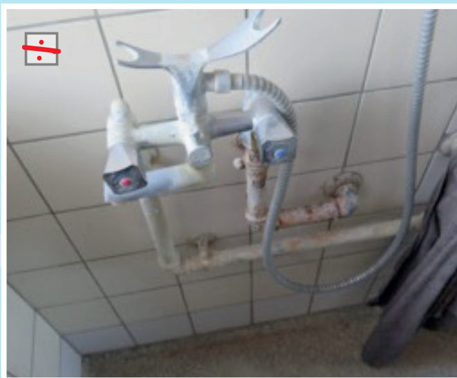
Billede 12: Kalk på blandingsbatteri i bruseniche
