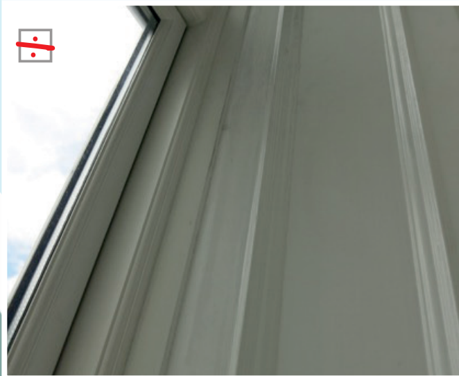
Billede 6: Vindueslysning. Malingslaget på vindueslysnin-gen dækker ikke.
